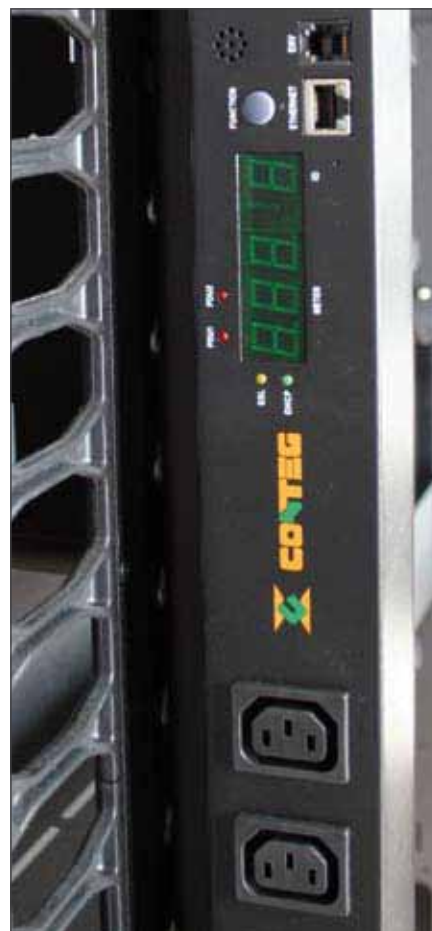
Monitorovaný napájecí panel
